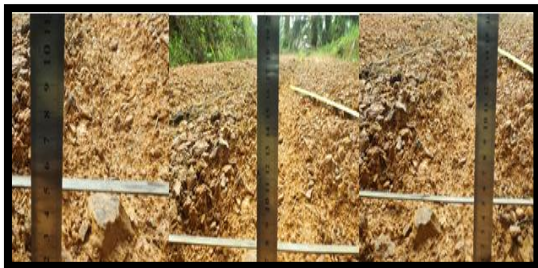
Gambar 4. Pengukuran kedalaman erosi alur pada jalan koleksi
