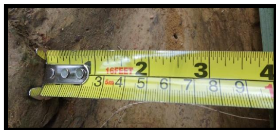
Gambar 2. Pengukuran lebar erosi alur pada jalan koleksi
