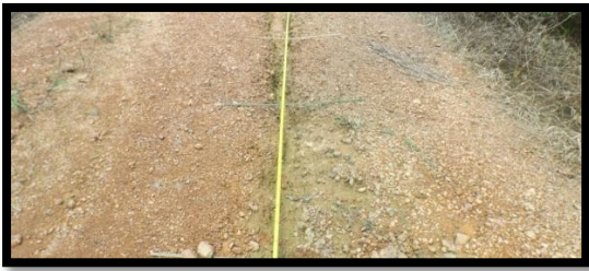
Gambar 6. Badan jalan yang rusak akibat terbentuknya erosi alur
